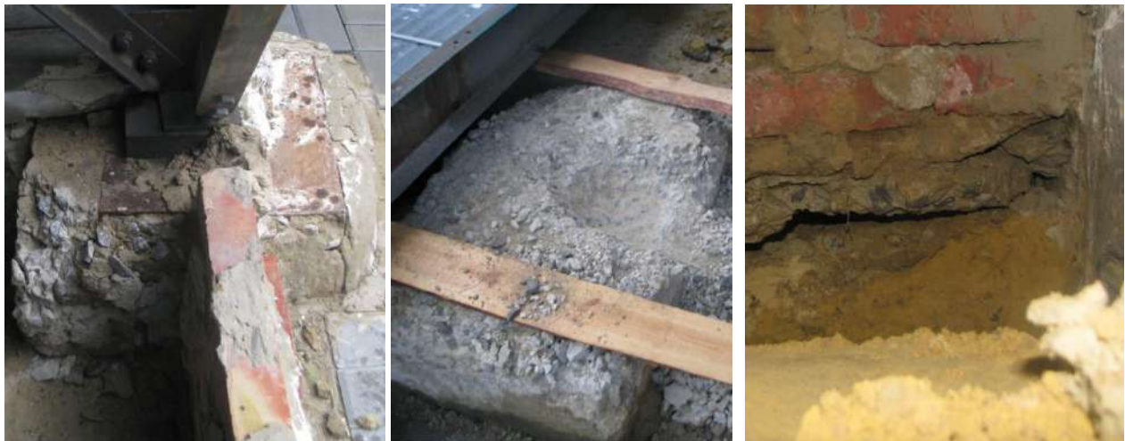
Рис. 2. Зовнішній вигляд конструкцій фундаменту ГПА №2: опорна конструкція в осях «1.1» х «А» (а); конструкція в осях «2.2» х «Б» (б); розріз стяжки в осях «1.1» х «В» (в).
